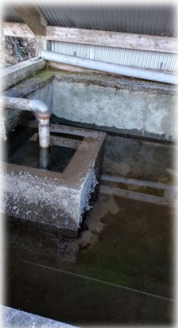
地区の給水タンク
